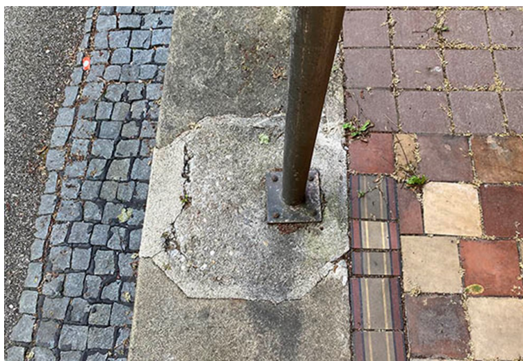
Figura 16: Pilar del pórtico norte cimentado sobre base hexagonal, huella del pilar desaparecido. Baldosa original de la intervención de Gartner. Fuente: elaboración propia, 2023.
