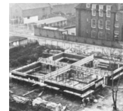
figura 15 Construcción de la plataforma en Brunswick Park Primary School, Camberwell, London, England. 1958 – 1961.
